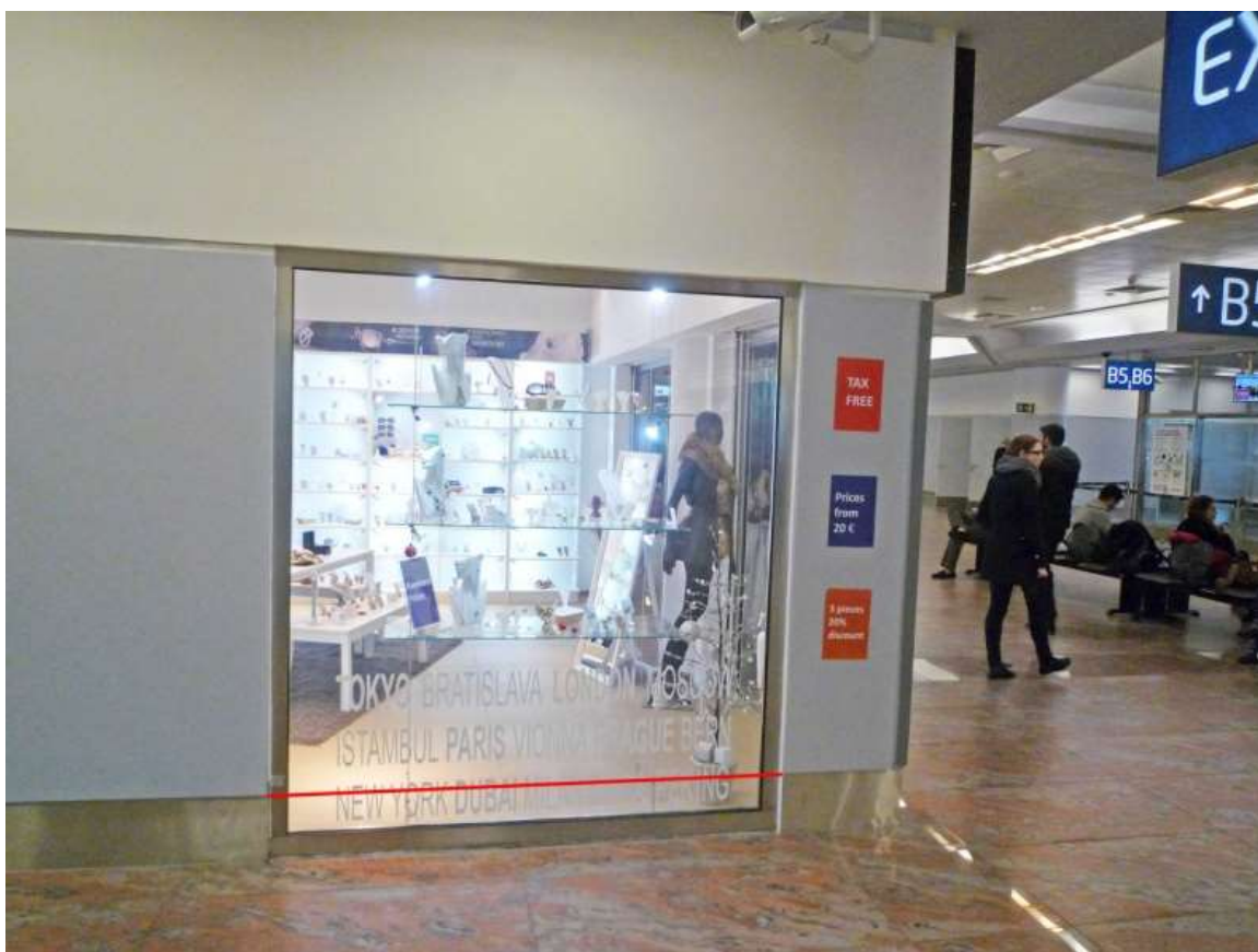
Ukázka nevhodného provedení výlohy (spodní profil je nižší než stávající sokl - správně mají být ve stejné úrovni)
